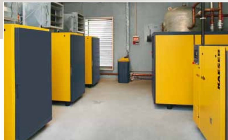
Новая компрессорная станция «Kaeser» для обеспечения сжатым воздухом компании «Interroll» (г. Вермельскирхен)
